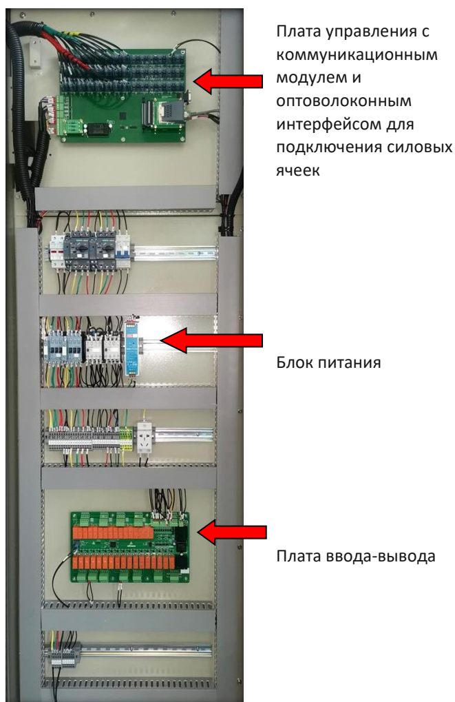
Рис. 1.11 - Вид секции управления без дверной панели
